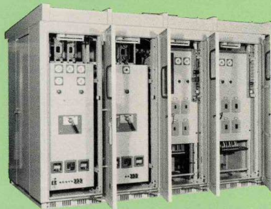
図7 ばね操作式VCB収納の受電盤例
