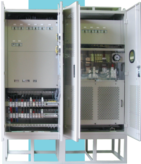
電源切替盤 変圧器盤
